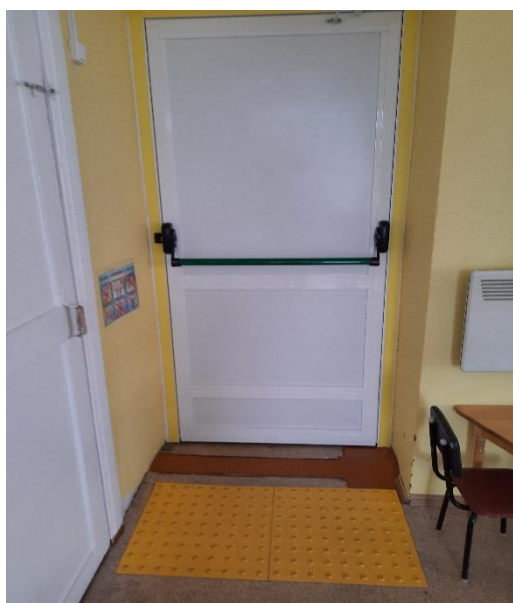
Специальные двери для инвалидов-колясочников с удобным открыванием и закрыванием, расширенные дверные проемы.
